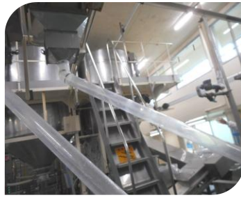
パイプを通り蒸気で炊きます
